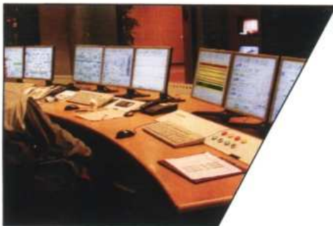
■ Salle de contrôle
